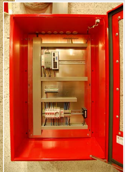
Stort servicevennlig teknisk rom bak skillevegg
