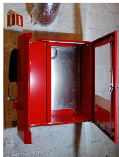
Skilleveggen er hengslet for fri adgang når det jobbes i skapet.
