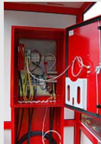
Teknisk skap med plass for fiberpanel, nettverk og elektro
